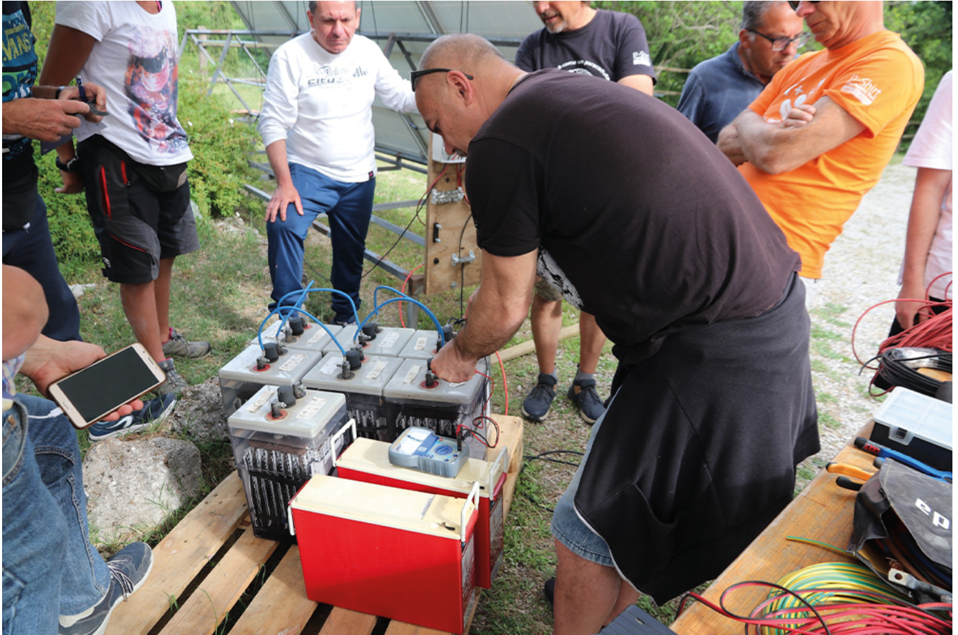
Collegamento degli accumulatori ai pannelli fotovoltaici
